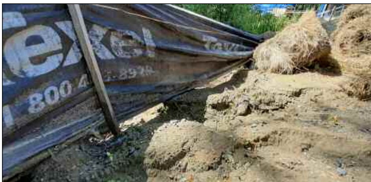
Example of a faulty sediment barrier/ Exemple d'une barrière de sédiments défectueuse
